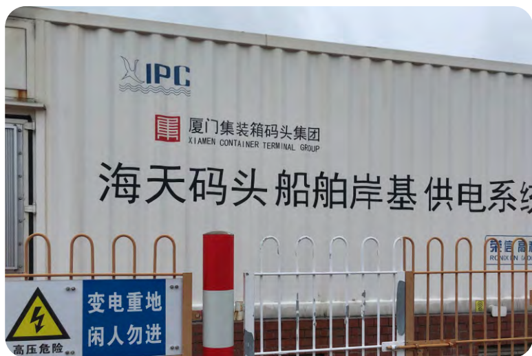
厦门港海天码头岸电设施 图/自然田
