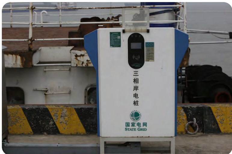
芜湖港国际集装箱码头的岸电设施 图 | 自然田
