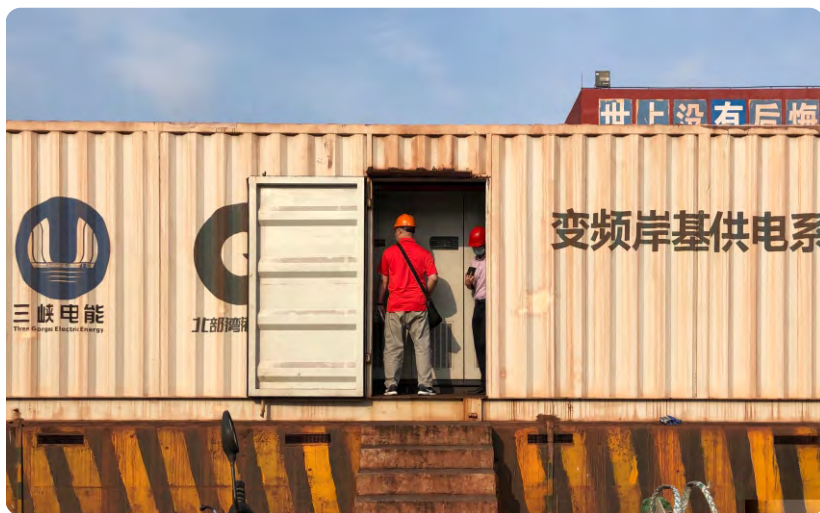
广西防城港港区的高压岸电设施 图 | 自然田
