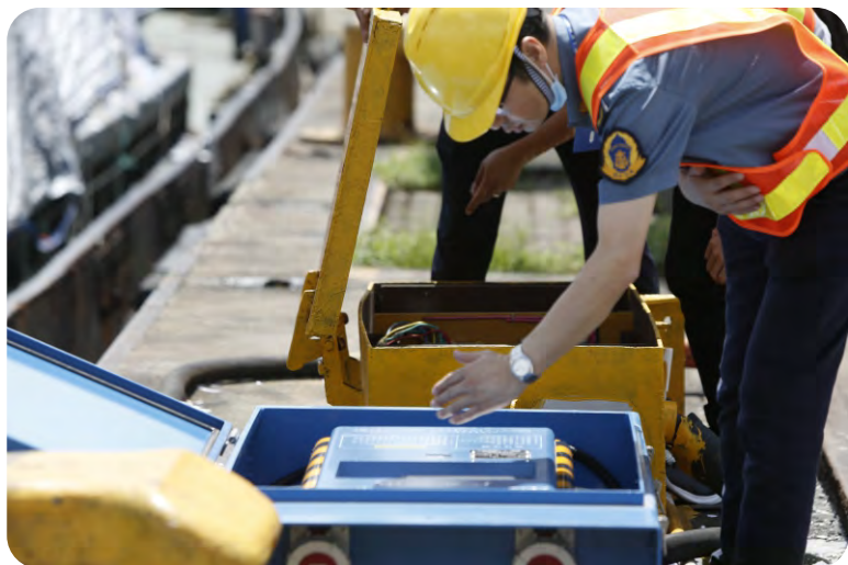
桂城港航管理所与码头工作人员检查岸电设施蓝色为新建设施，黄色为原有设施 图 | 自然田
