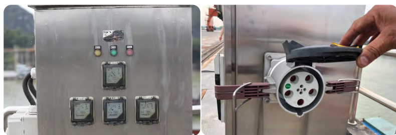
苏湾作业区岸电设施正面与侧面 图/自然田
